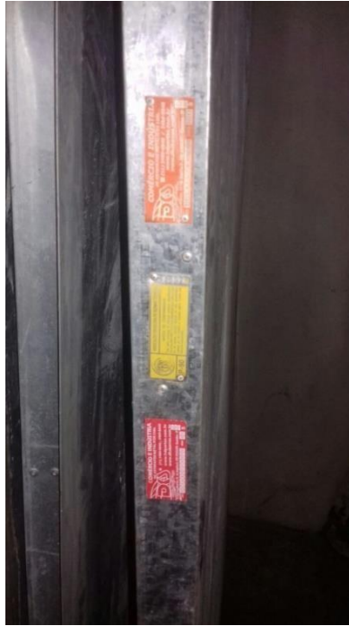
Foto 5: Selos de identificação nas portas corta-fogo.
