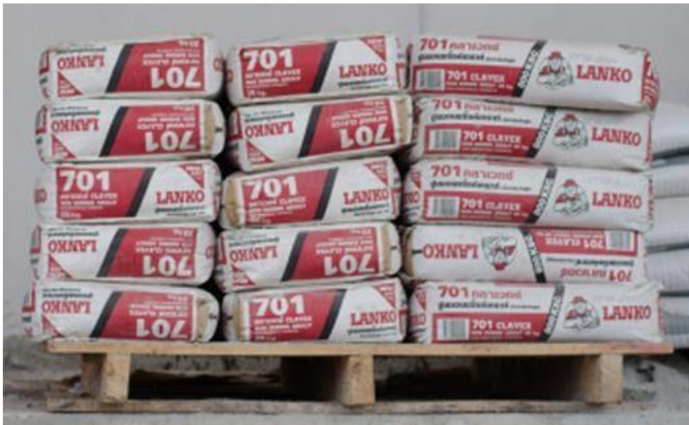
Foto 1: Empilhamento de Argamassa.
