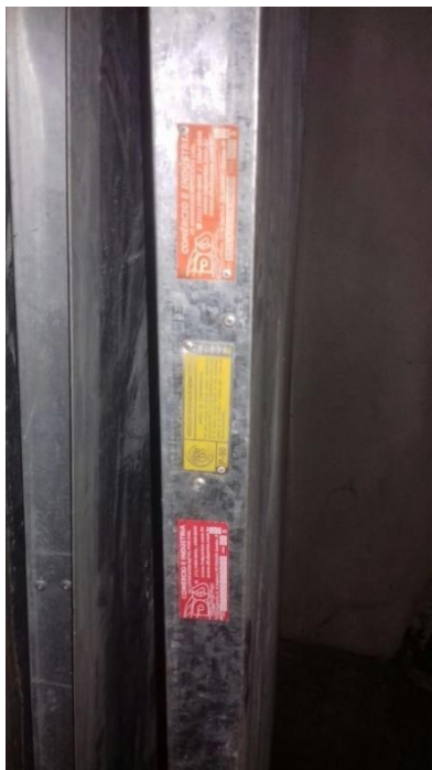
Foto 5: Selos de identificação nas portas corta-fogo.
